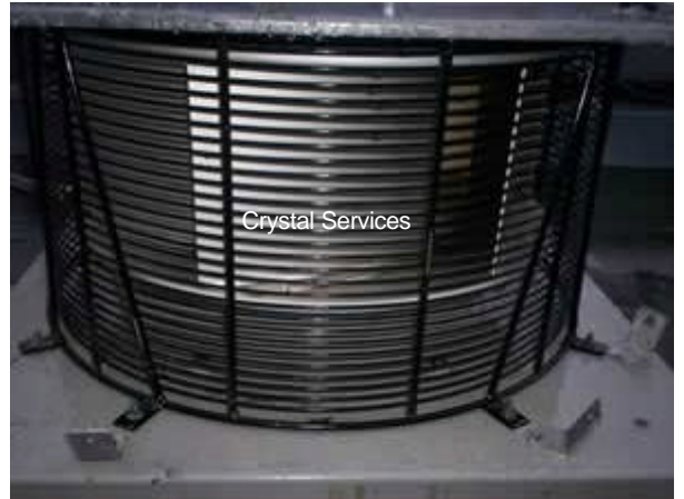
Dachventilator Fettabluft nachher
