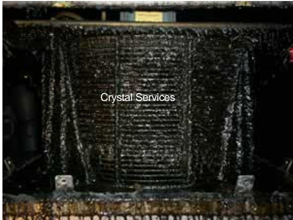
Dachventilator Fettabluft vorher
