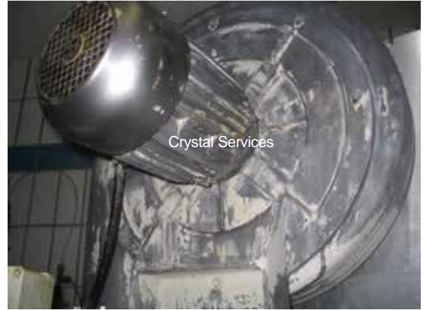
Prozessabluft Ventilator nachher
