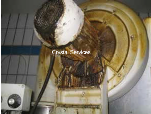
Prozessabluft Ventilator vorher
