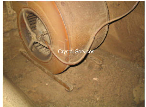
Lüftungszentrale Ventilator und Ventilatorkasten stark mit Staub verlegt, Dämmmaterial stark beschädigt, wird über den Zuluftstrang in die Räumlichkeiten befördert (gesundheitsschädigend)
