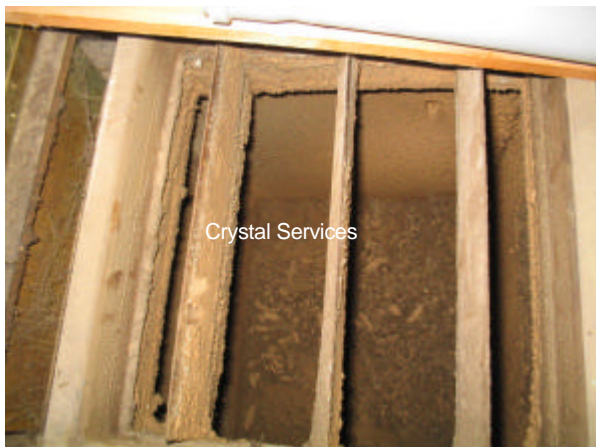
Kanal hinter den Stellklappen Hygiene, Bakterien
