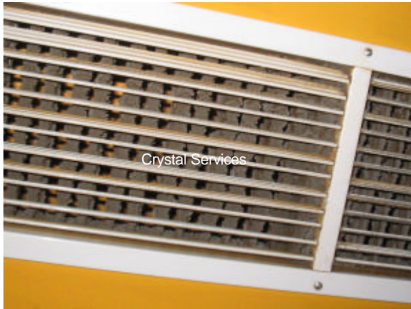
Lüftungsgitter stark mit Staub verlegt, Hygiene, Bakterien, starker Leistungsverlust
