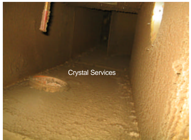
Kanal in der Lüftungsstation Hygiene, Bakterien
