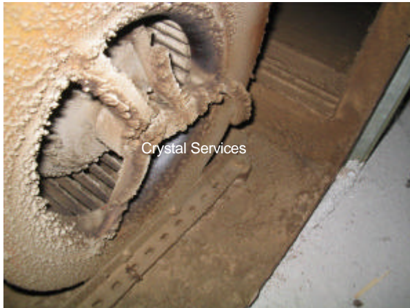
Lüftungszentrale Ventilator stark mit Staub verlegt, Hygiene, Bakterien, starker Leistungsverlust
