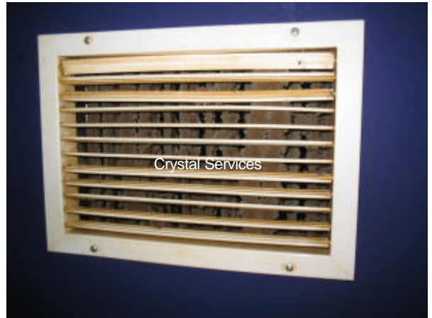
Lüftungsgitter stark mit Staub verlegt
