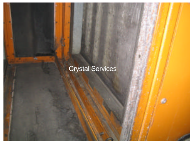
Dämmmaterial beschädigt (lungengängig)
