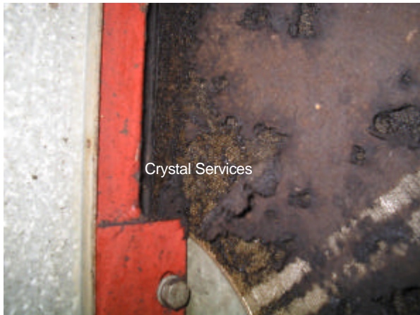
Rotationswärmetauscher total mit Staub u. Fettablagerungen verlegt.
