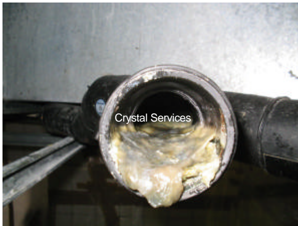
Bereich Küchenfettabluft Abflußrohr vorher /mit Fettablagerungen verlegt Wasser kann nicht mehr ungehindert abrinnen Gefahr des Wasserüberlaufens
